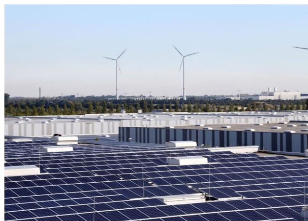
3'608 kWp-Anlage Alter Flughafen Leipzig
