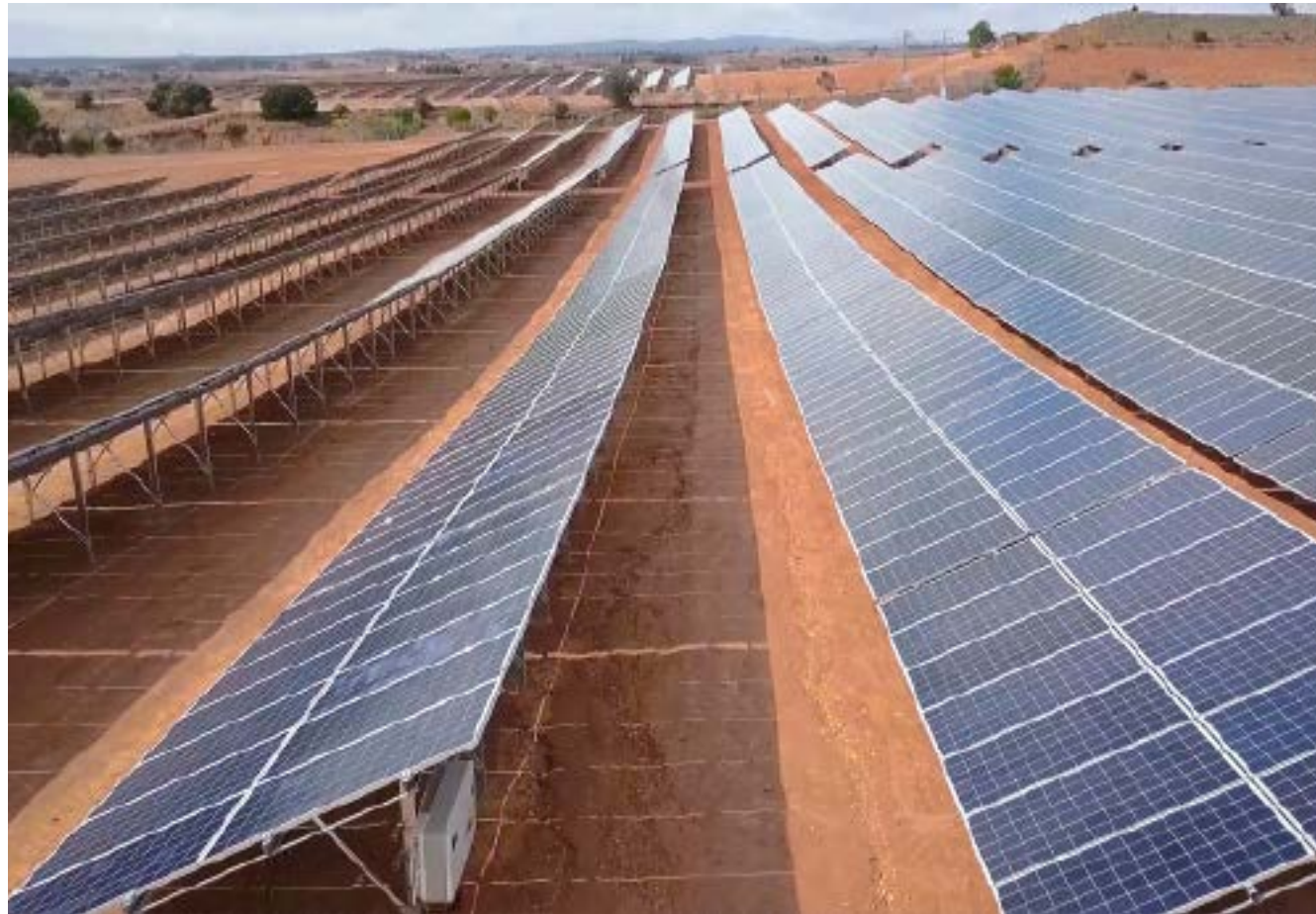
Blick auf die neue 12-Megawatt-Photovoltaikanlage von Edisun in Requena, 70 Kilometer westlich von Valencia.
