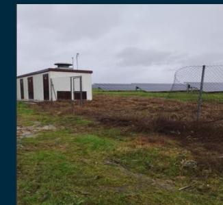
Condado – Cables theft
